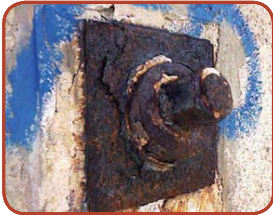
Figura 1 - Corrosão dos tirantes da cortina apresentando perda de seção
