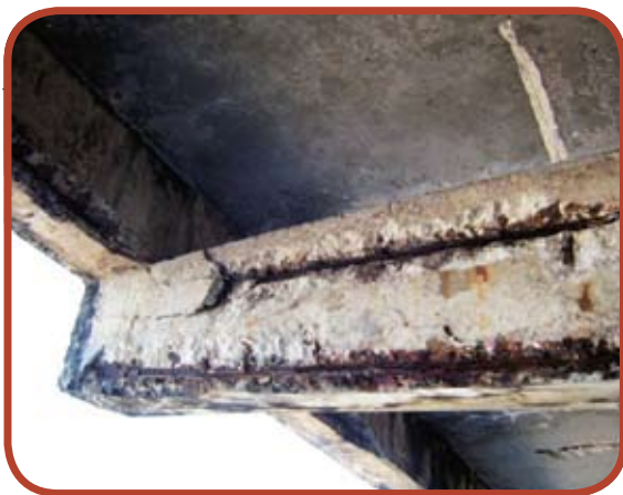
Figura 9 - Viga em balanço com corrosão, com perda de seção das armaduras
