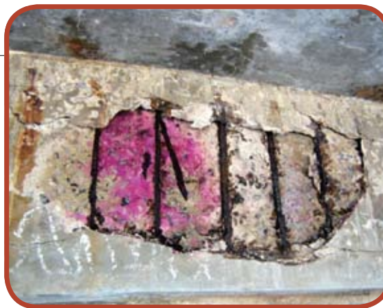
Figura 10 - Viga com corrosão, com perda de seção das armaduras
