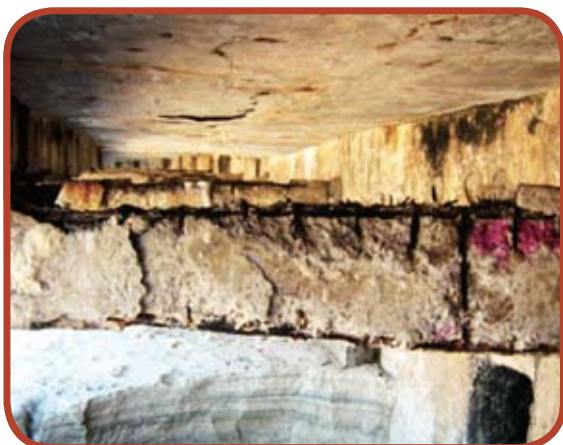
Figura 11 - Vigas em balanço com corrosão, com perda de seção das armaduras
