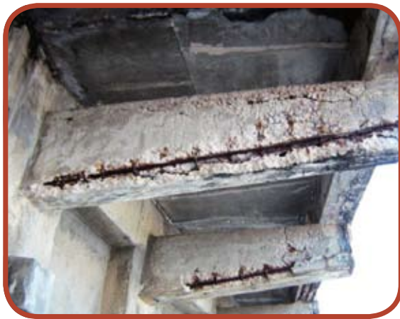
Figura 7 - Vigas em balanço com corrosão, com perda de seção das armaduras
