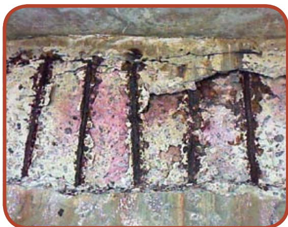
Figura 3 - Corrosão com perda de seção das armaduras de viga com indicação da não penetração do gás carbônico na estrutura (cor rosa, após a aspersão da fenolftaleína)
