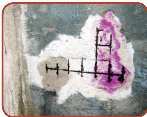
Figura 6 - Ensaios de cloretos e carbonatação em laje com corrosão, com perda de seção das armaduras, evidenciando a presença de cloretos no concreto e a não penetração do gás carbônico
