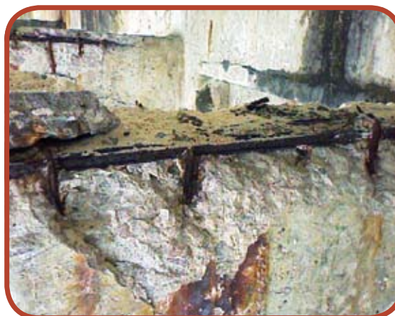
Figura 12 - Detalhe de viga em balanço com corrosão, com perda de seção das armaduras
