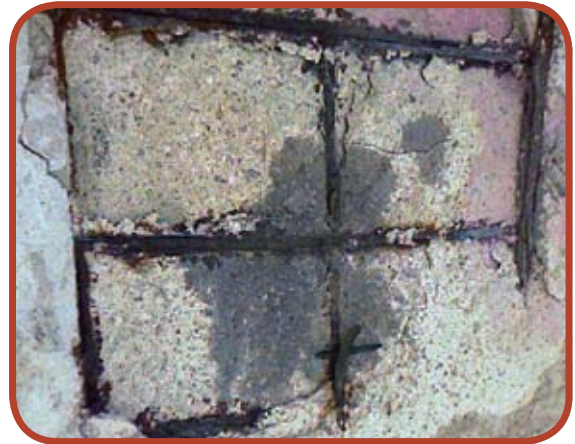
Figura 2 - Parede da cortina com perda de seção das armaduras com indicação de presença de cloretos (cor marrom, após aspersão de nitrato de prata)
