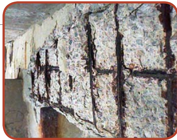
Figura 8 - Viga com corrosão, com perda de seção das armaduras
