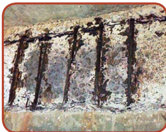
Figura 4- Corrosão com perda de seção das armaduras de viga com indicação da presença de cloretos na estrutura (cor marrom, após a aspersão do nitrato de prata)
