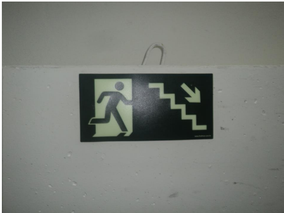
Figura 9: Foto de sinalização de rota de fuga.
