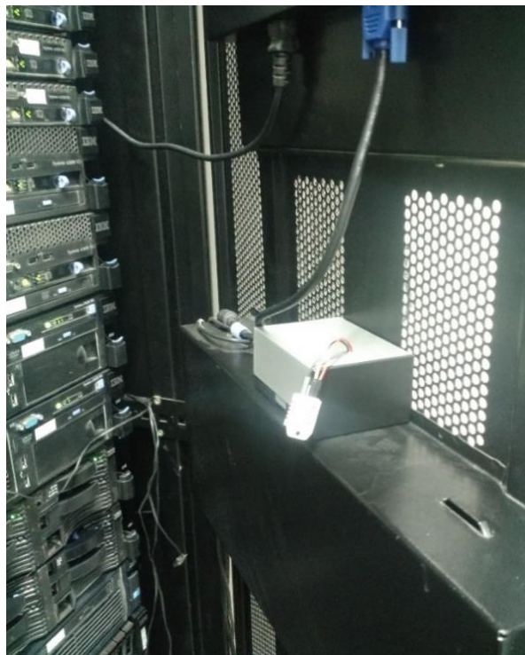
Figura 14 – Local de instalação do sistema de monitoramento
