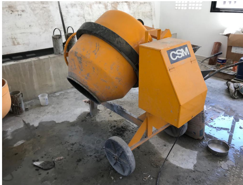
Figura 18 - Betoneira utilizada para a mistura do cimento, agregado, água e fibra de coco.
