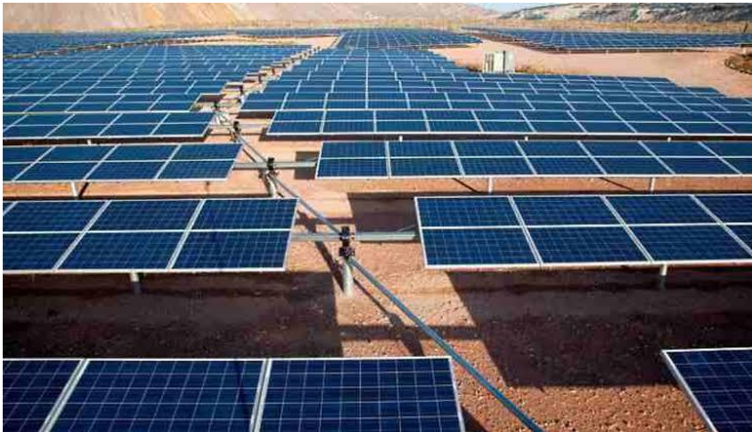
Figura 3 – Usina Solar Apodi.
