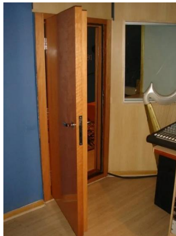
Figura 23- Isolamento acústico na porta.
