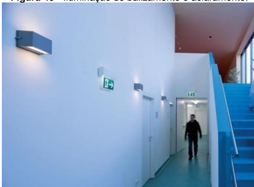
Figura 49 - Iluminação de balizamento e aclaramento.
