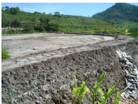
FIGURA 4 – Resíduos alocados de maneira inadequada
