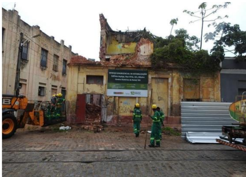
Figura 23 - serviço emergencial de estabilização de edificação de destaque abandonada e em processo de arruinamento, localização Rua Chile, realizado pelo Iphan/RN e 2020
