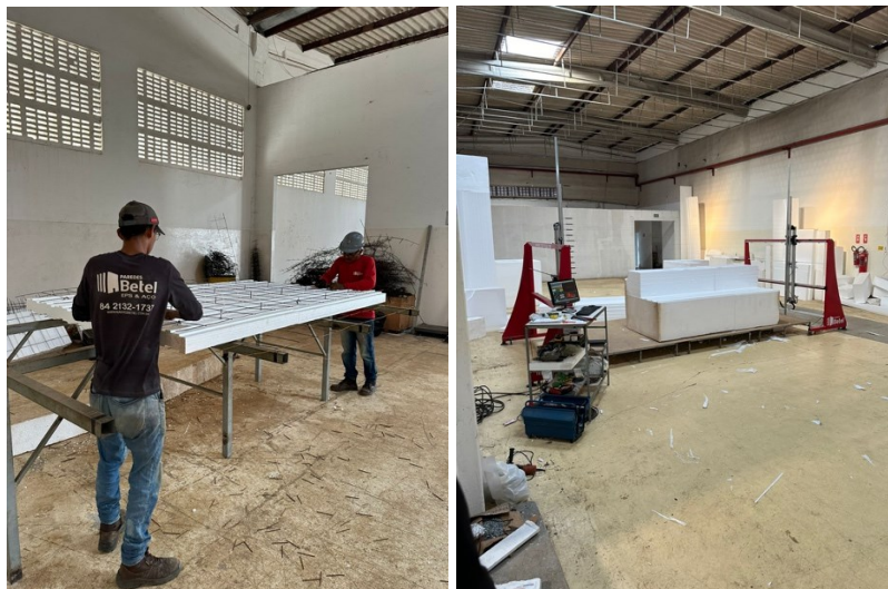
Figuras 4 e 5: Painéis sendo montados na fábrica da Betel Paredes em São José de Mipibu/RN.
