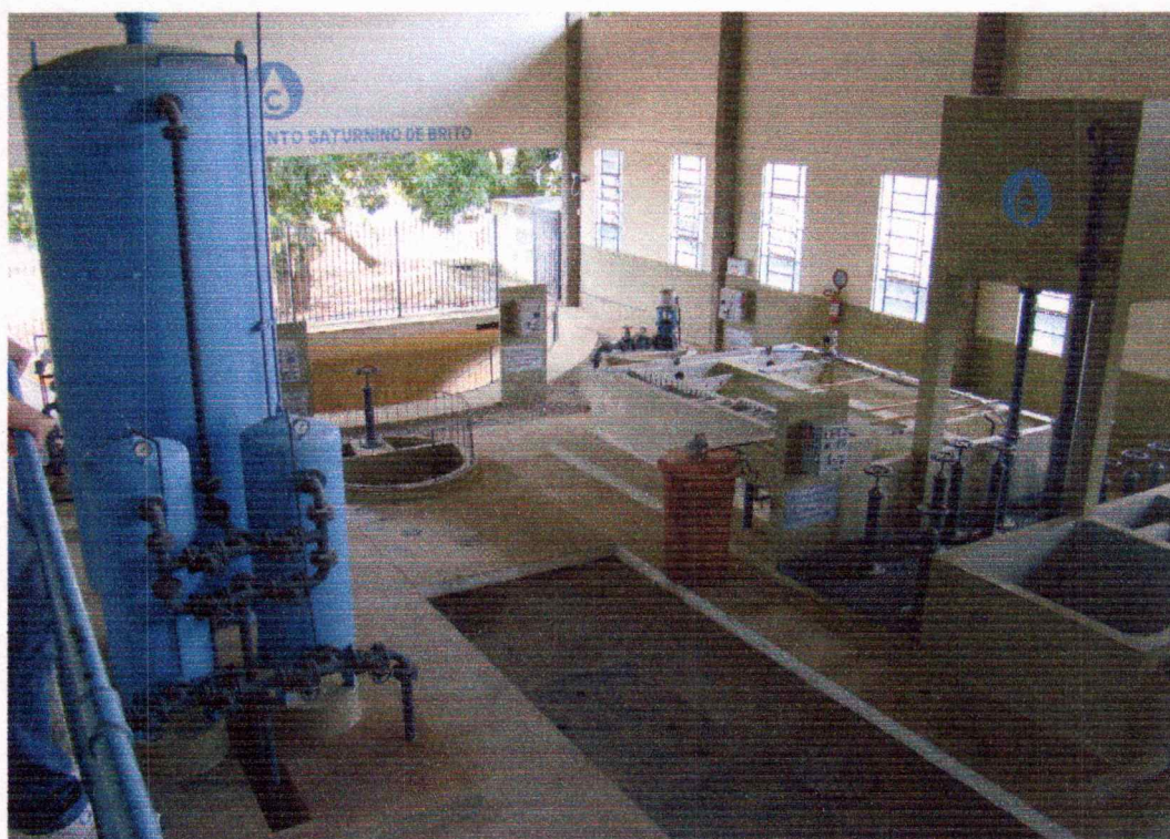
Figura 4 – Entrada da Mini Estação de tratamento Saturnino de Brito
