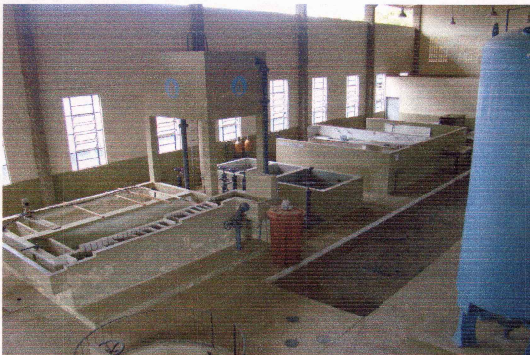
Figura 8 – Estação de tratamento
