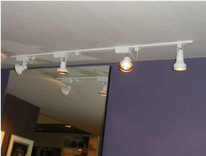
Foto 03 Iluminação com trilho.
