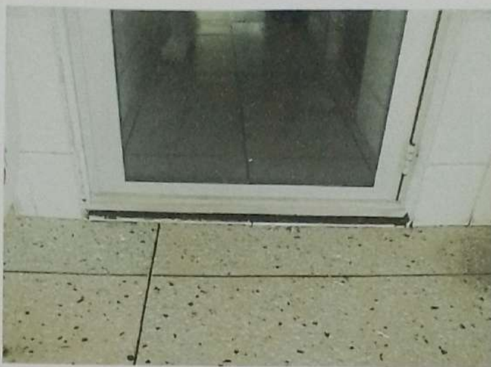
Figura 12 – Veda-porta da sala de envase
