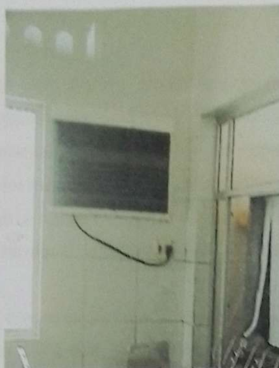
Figura 14 – Ar condicionado da sala de envase.
