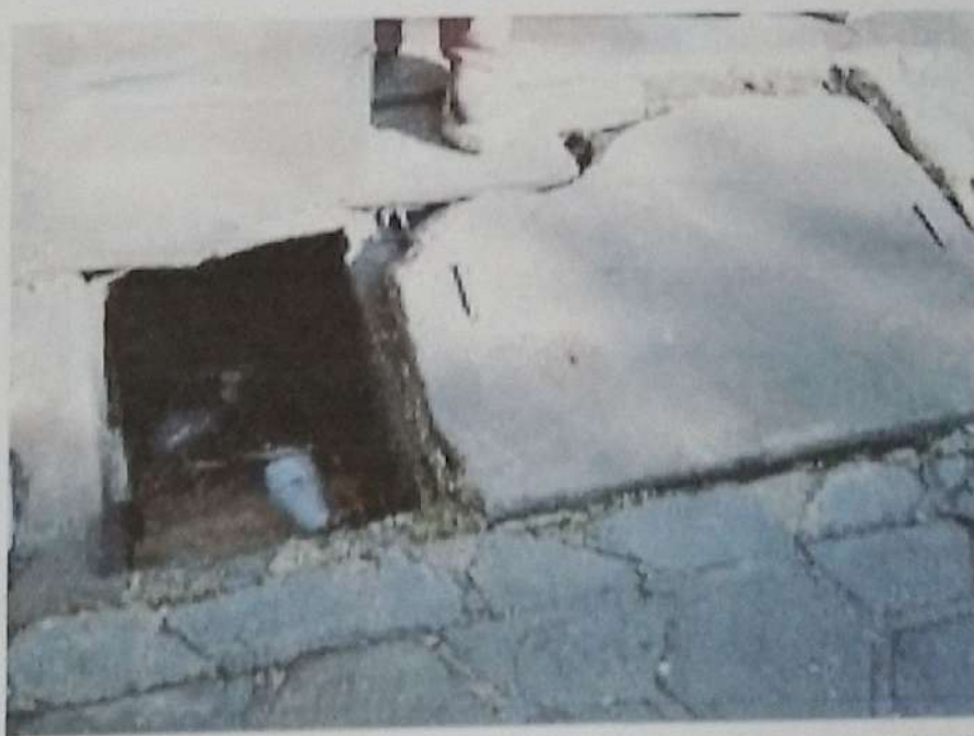
Figura 7 – Caixa separadora de água e óleo em péssimo estado de operação.
