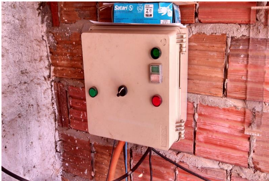
Figura 4 - Controle de bomba de soda cáustica.
