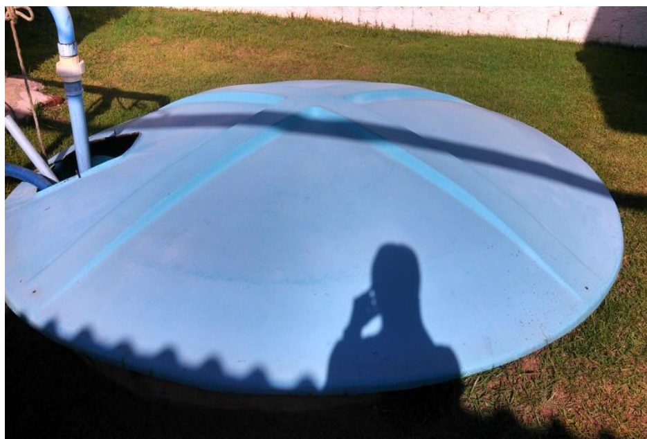
Figura 6 - Tanque de acumulação e decantação (parte externa).
