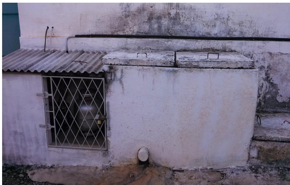
Figura 2 - Caixa de passagem e equalização inicial.
