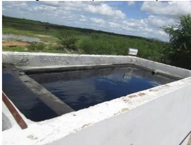
Figura 11. Tanque de Decantação
