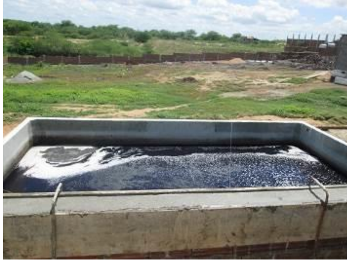
Figura 9. Tanque de Equalização
