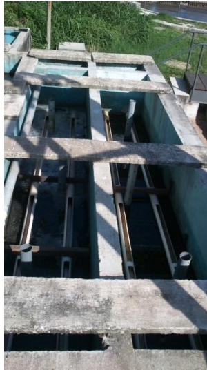
Figura 2.5. Reatores aerado 1 e aerado 2
