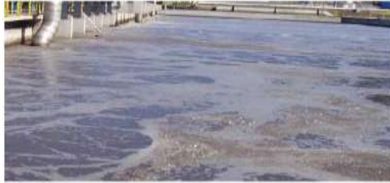
Tanque de aeração
