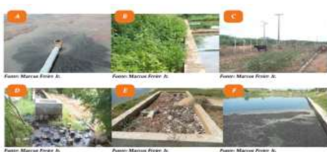
Foto 1. Alguns dos problemas corriqueiros observados em SES, resultantes da falta de atividades de operação e manutenção periódicas ou das mesmas sendo exercidas de forma incorreta: Assoreamento dos sistemas (A); Grande quantidade de vegetação dentro e fora dos sistemas (B); Presença de animais dentro dos sistemas (C); Vazamentos em equipamentos dos sistemas (D); Disposição de lixo em equipamentos dos sistemas (E); Grande quantidade de lodo sobrenadante dentro das lagoas de estabilização (F).
