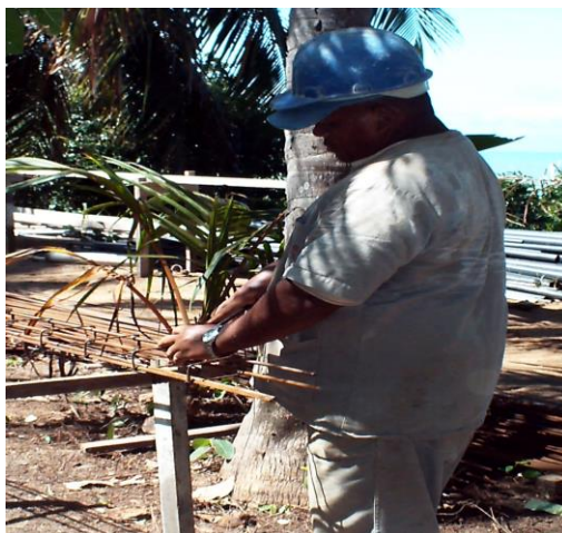
Figura 3 - Funcionário (na função de armador) sem a maioria dos equipamentos de proteção individual. Fonte: Autoria própria, 2011.
