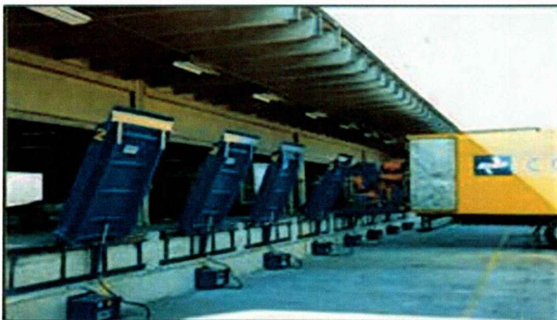
Figura 27: Plataforma niveladora para o recebimento de "secos" Fonte: IMAM
