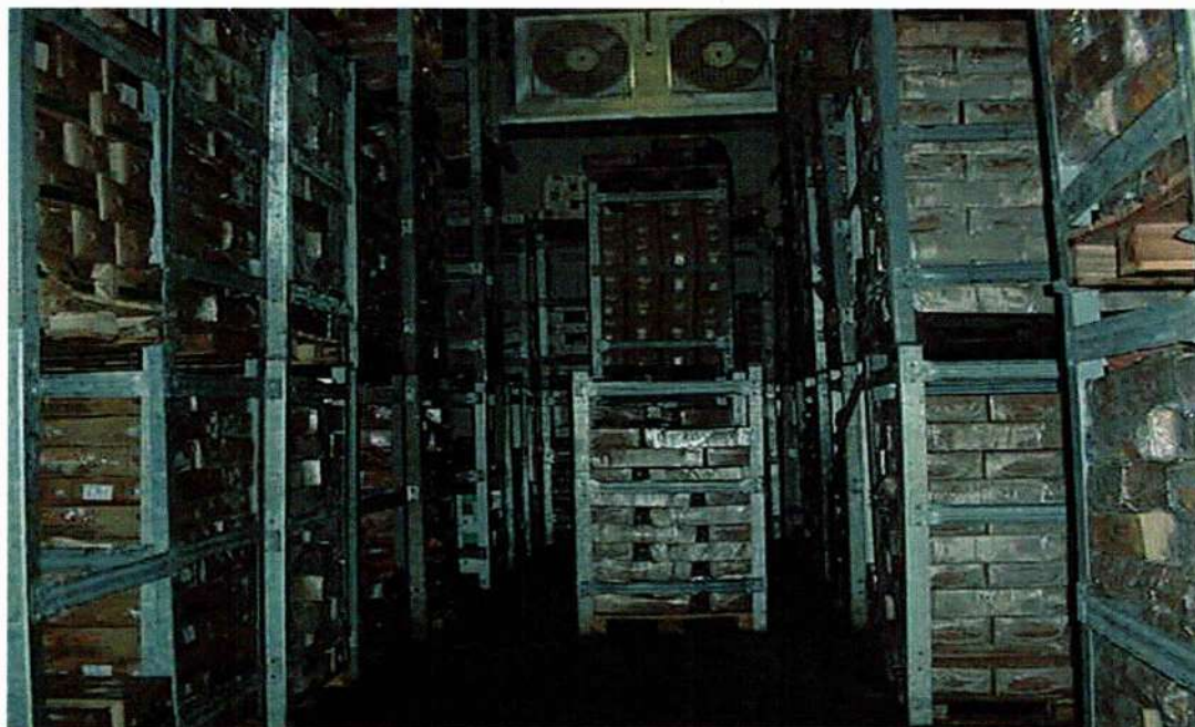
Figura 23: Armazenamento de produtos (câmara frigorífica) Fonte: Uvifrios/2007
