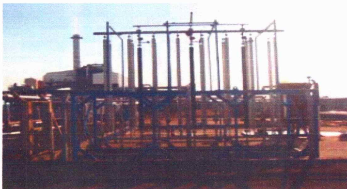
Figura 1 - Unidade de decompressão do gás natural Fonte: Ellos Gás e Tecnologia do Brasil (2005).
