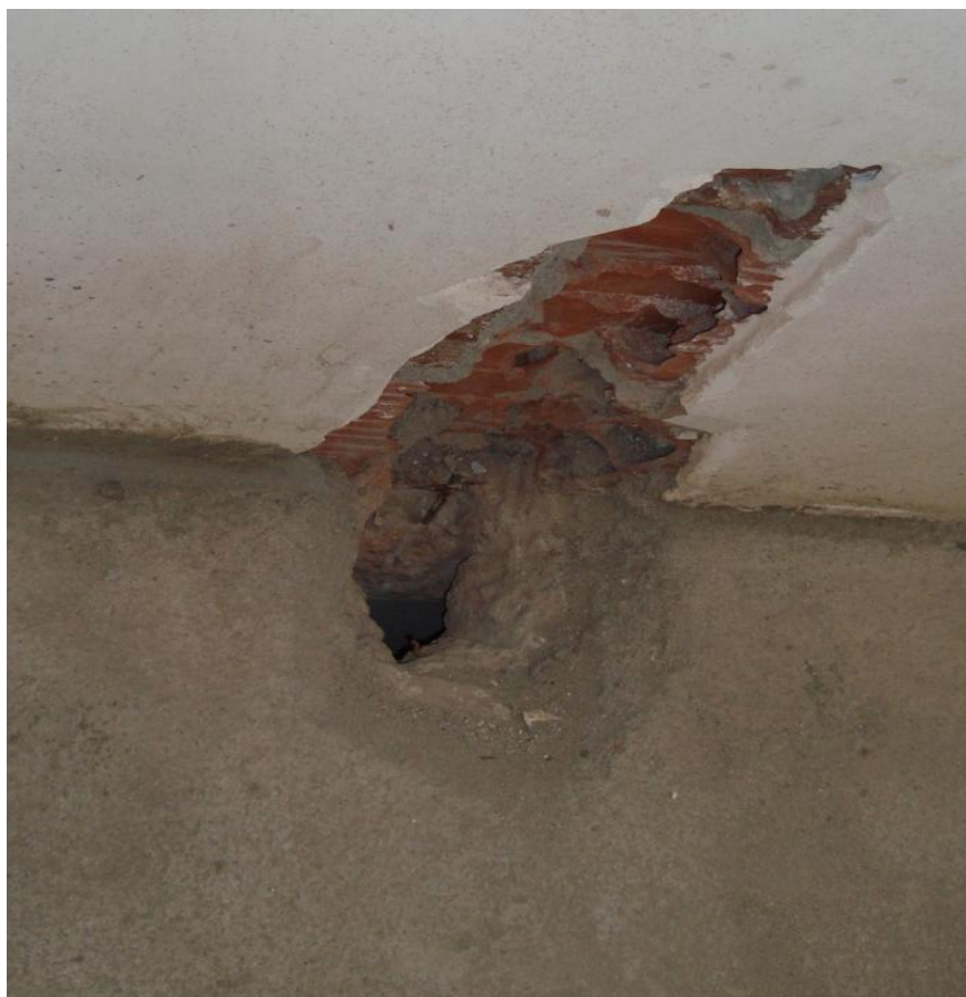
Figura 6 - Erro no processo construtivo, que causa desperdício.
