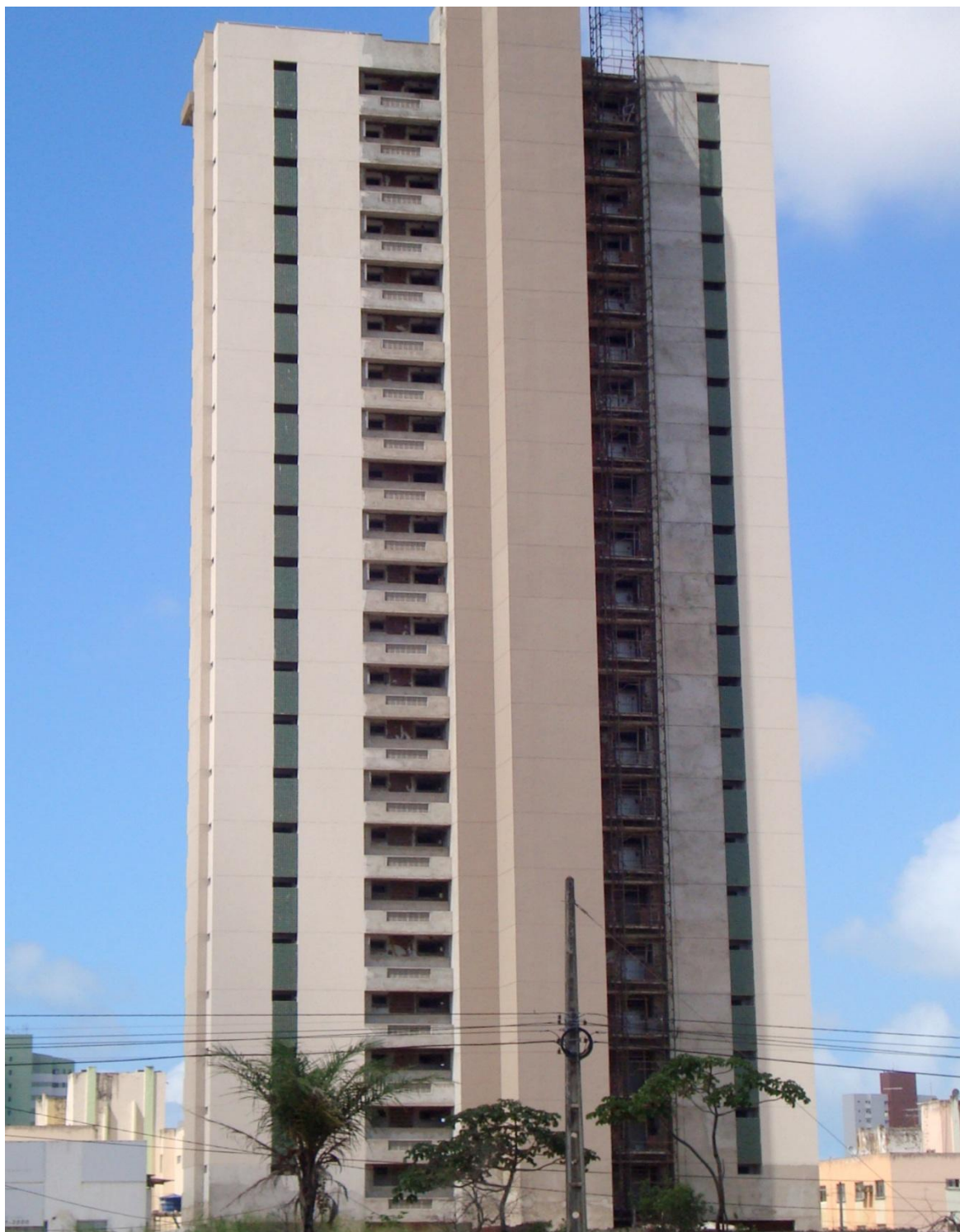
Figura 4 - Fachada do edifício não concluída pelo descumprimento do mapeamento de processos.
