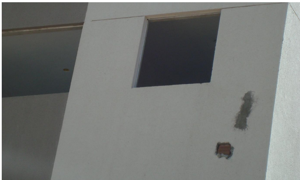
Figura 9 - Ponto com alto índice de patologia futura.
