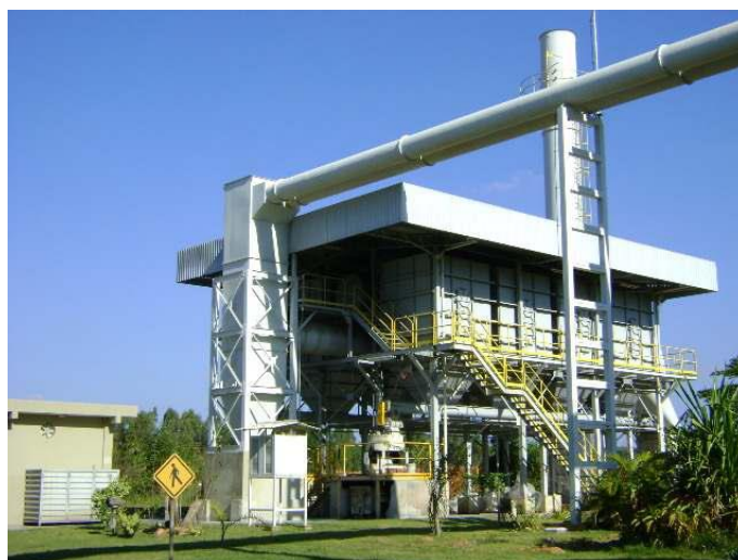
Figura 8: Sistema da filtros de despoeiramento Fonte: TUDOR MG
