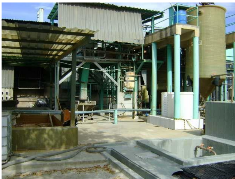
Figura 12: Estação de tratamentos de Efluentes Fonte: Tudor MG
