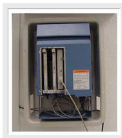
Figura 5: Repetidor localizado junto ao medidor residencial.
