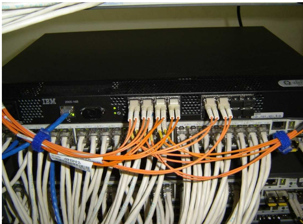
Figura 11: Switch IBM B16 da JFRN e suas conexões em fibra óptica.
