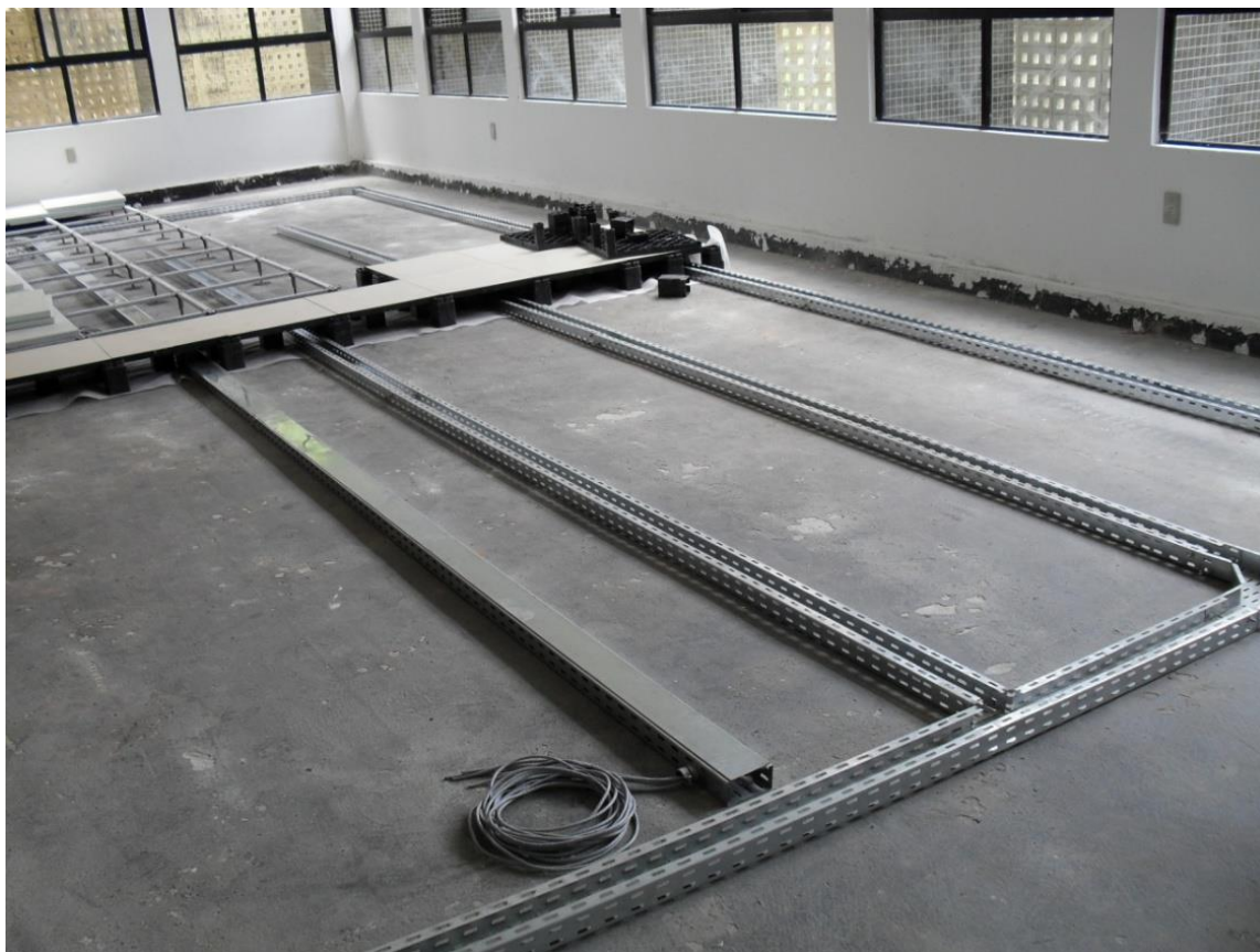
Imagem 4 - Estrutura de Eletrocalhas
