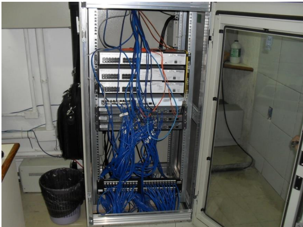
Imagem 3 - Racks de Ativos
