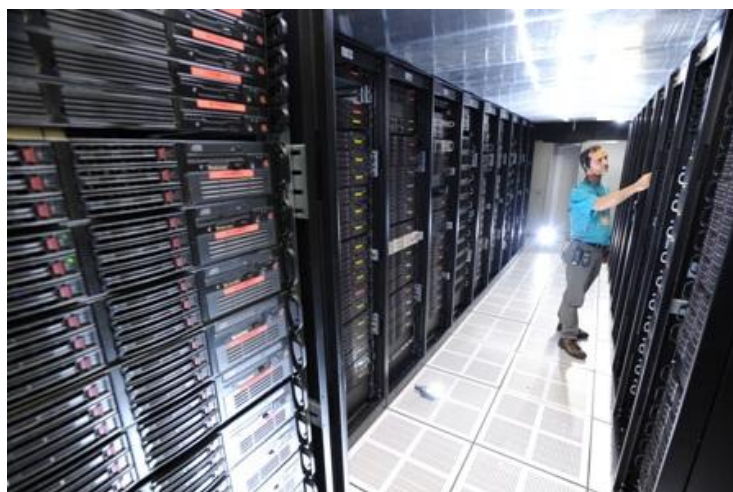
Figura 6 – Datacenter verde da Locaweb
