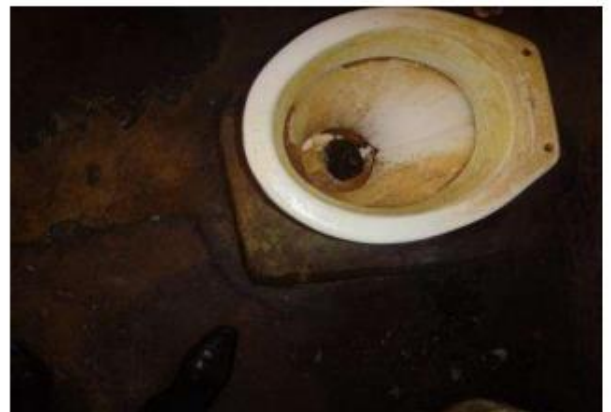
Banheiro sem qualquer higiene ou limpeza Foto 2
