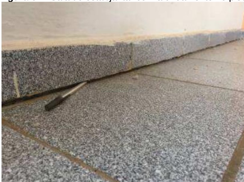
Figura 61 - Sala de estar/jantar com afundamento no piso.
