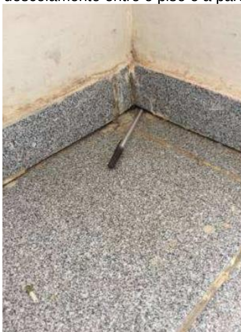
Figura 62 - Detalhe do descolamento entre o piso e a parede em um dos quartos.
