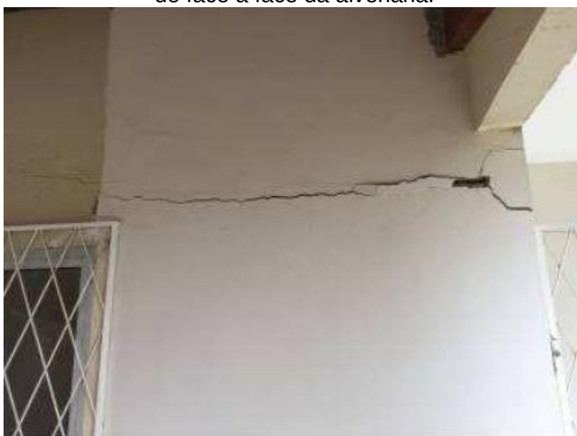
Figura 66 - Trinca horizontal mostrada na Figura 64, nesta vista externa, se estende de face a face da alvenaria.
