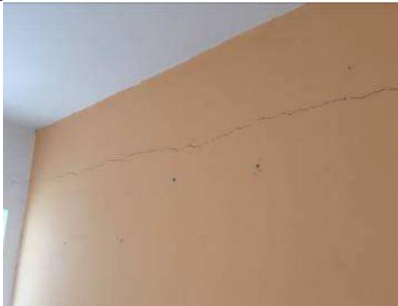
Figura 63 - Parede com trinca horizontal em toda a extensão.
