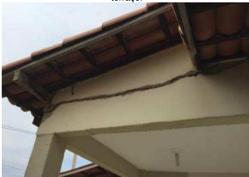
Figura 58 - Fenda em sentido horizontal localizada acima da cinta superior do terraço.
