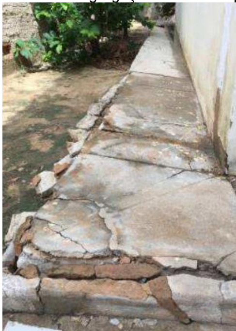
Figura 67 - Canto da calçada periférica (borda do radier) na parte frontal do imóvel com deslocamento e desagregação intensa do piso cimentado.
