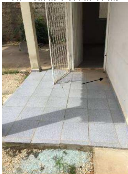
Figura 59 - Terraço frontal com afundamento do piso. Algumas peças cerâmicas danificadas e outras soltas.
