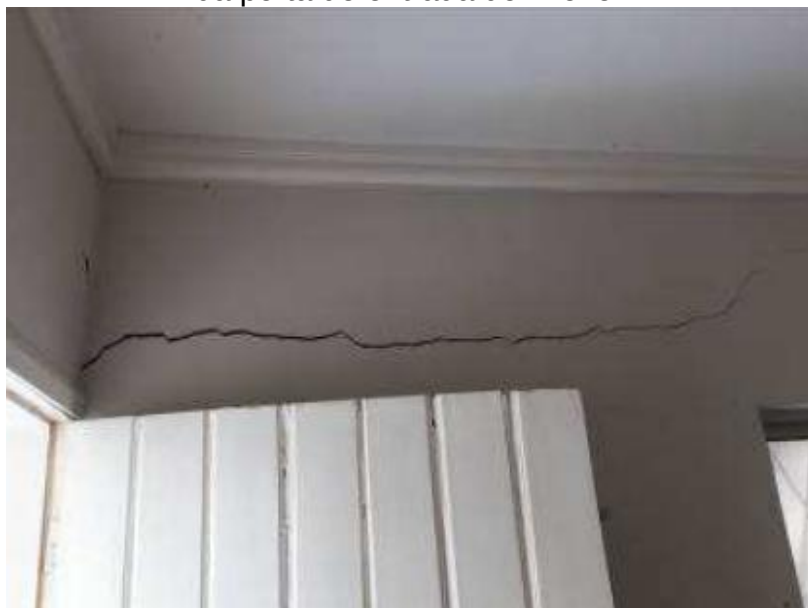
Figura 64 - Trinca horizontal em parede da sala (frente do imóvel), acima e ao lado da porta de entrada do imóvel.
