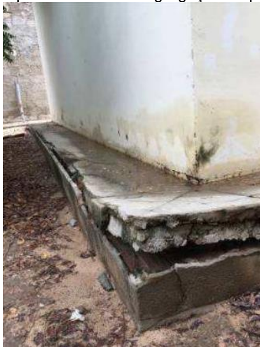
Figura 68 - Canto da calçada periférica (borda do radier) na parte posterior do imóvel com deslocamento e desagregação do piso cimentado.
