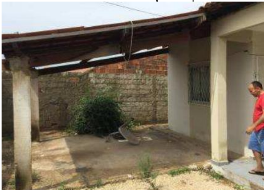
Figura 71 - Ampliação executada na área frontal do imóvel, mas que não possui qualquer influência na causa ou na evolução dos problemas observados.
