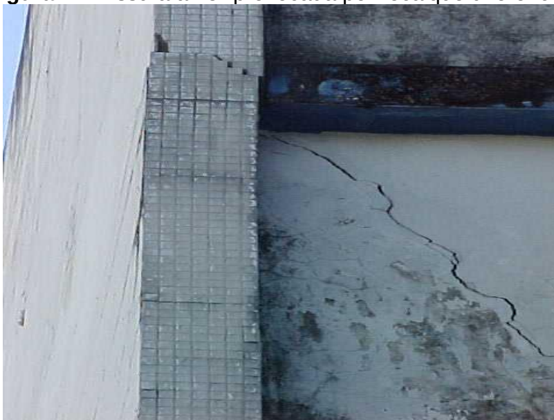
Figura 1 – Fissura a 45° provocada por recalque diferencial.
