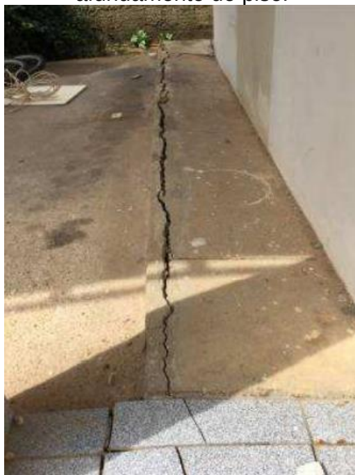
Figura 60 - Calçada periférica (borda do radier) com fenda longitudinal acusando afundamento do piso.
