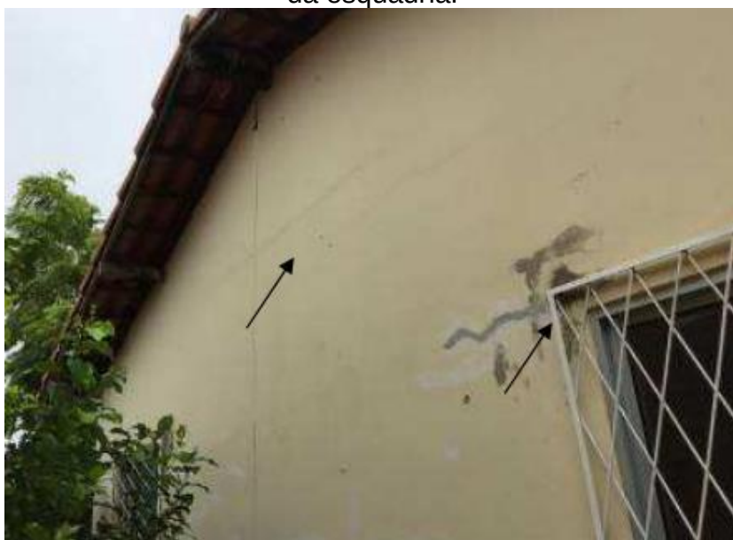
Figura 70 - Fachada lateral esquerda: Fissura horizontal coincidindo com cintamento superior e, mais abaixo, tentativa de reparo em trinca no vértice superior esquerdo da esquadria.
