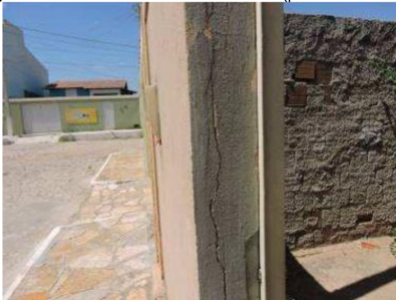
Figura 57 - Trinca vertical em muro frontal (portão de entrada).
