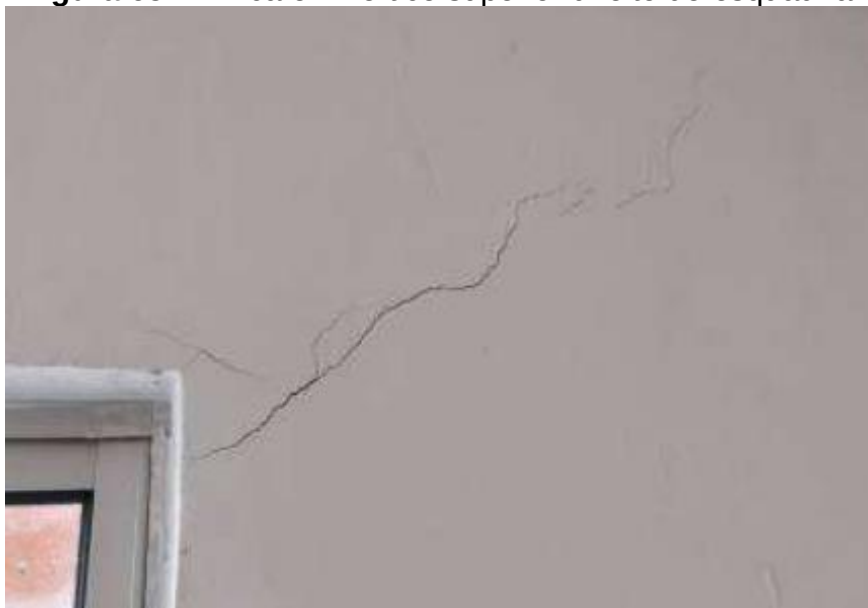
Figura 65 - Trinca em vértice superior direito de esquadria.
