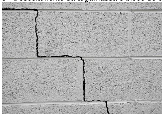
Figura 5 - Descolamento da argamassa e bloco de concreto.
