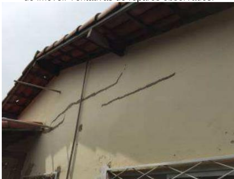
Figura 69 - Fissuras aleatórias dispostas horizontalmente na fachada lateral direita do imóvel. Tentativas de reparos observados.
