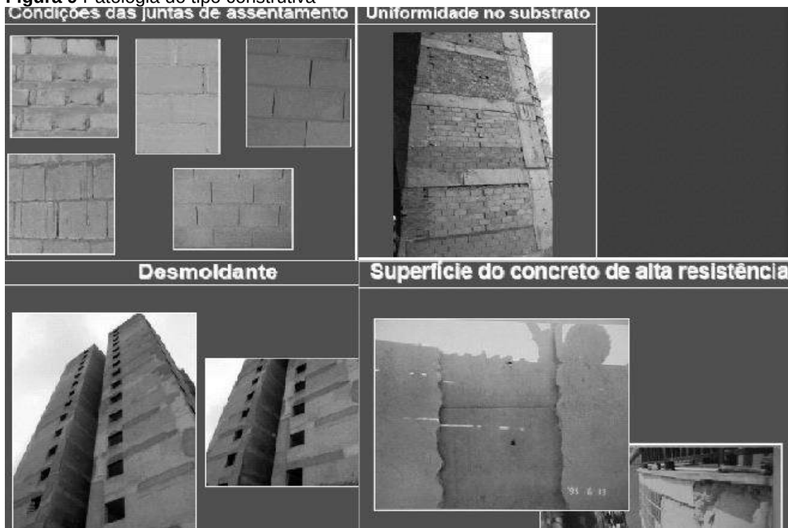
Figura 9 Patologia do tipo construtiva
