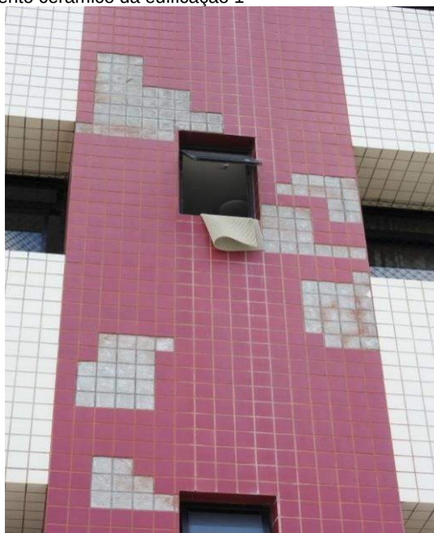
Figura 44 Descolamento cerâmico da edificação 1
