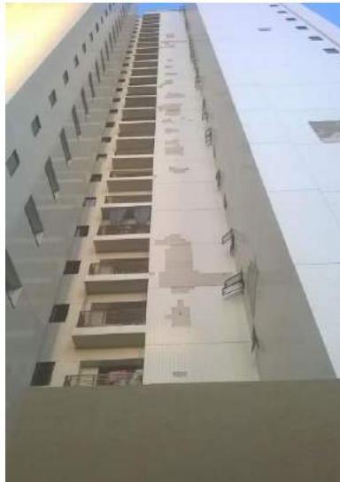
Figura 47 Descolamento cerâmico da fachada lateral da edificação 2
