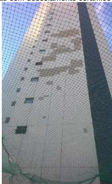
Figura 46 Fachada da Edificação com descolamento cerâmico da edificação
