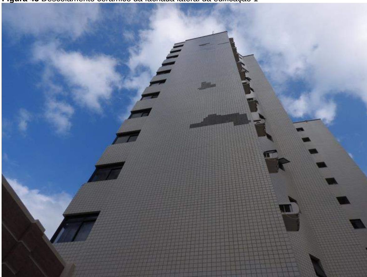
Figura 45 Descolamento cerâmico da fachada lateral da edificação 1
