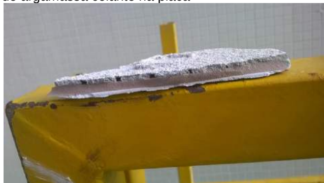
Figura 48 Ausência de argamassa colante na placa
