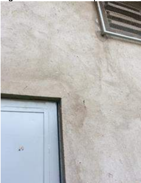
Figura 35 - Fissuras nas proximidades das esquadrias
