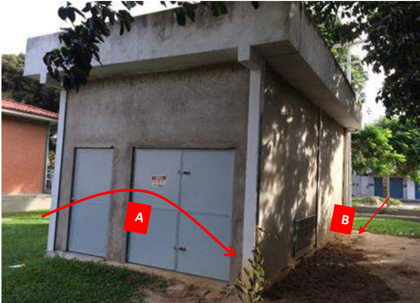
Figura 33 - a) Sentido de rotação da estrutura em função do recalque; b) Local de subsidência do solo
