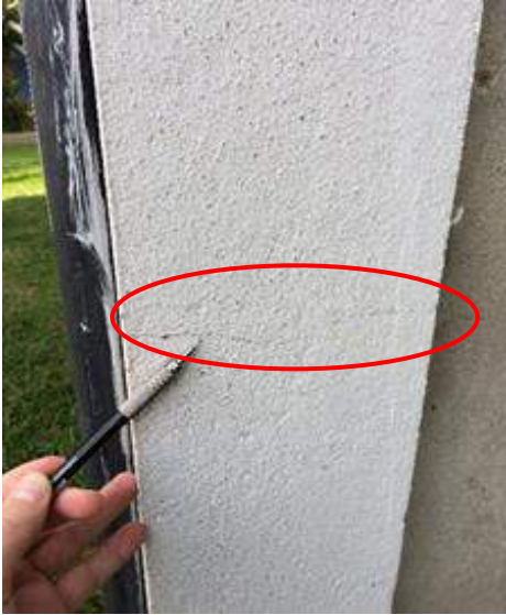
Figura 34 - Fissura em um dos pilares (situado no lado oposto ao lado da cessão do solo).
