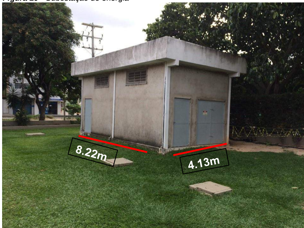
Figura 29 - Subestação de energia
