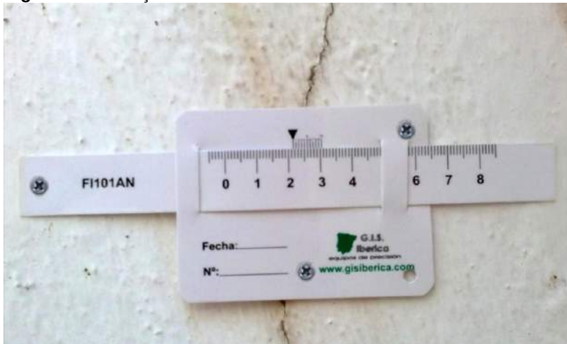
Figura 12 - Medição de fissuras com fissurômetro
