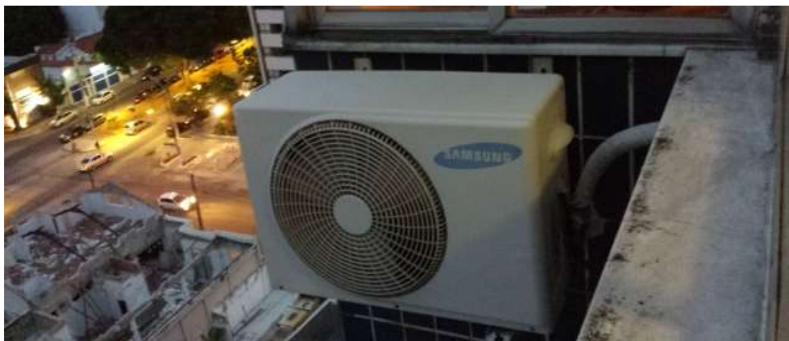
Figura 13 – Aparelho de ar-condicionado com sistema de coleta
