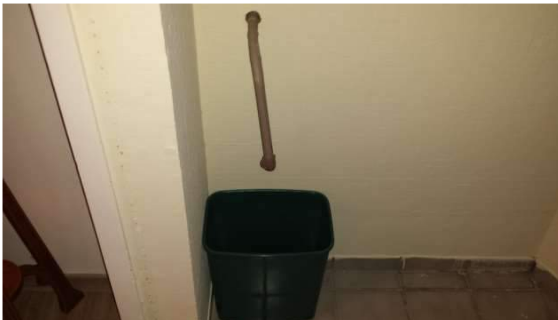
Figura 14 – Coletor de água do ar-condicionado
