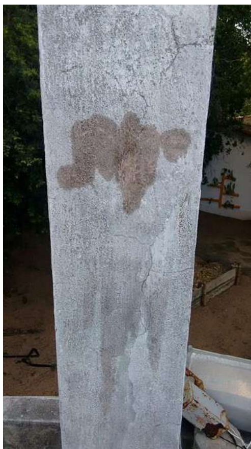
Figura 33 – Aplicação de nitrato de prata no pilar
