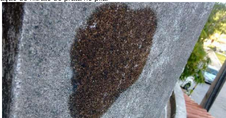
Figura 34 – Aplicação de nitrato de prata no pilar
