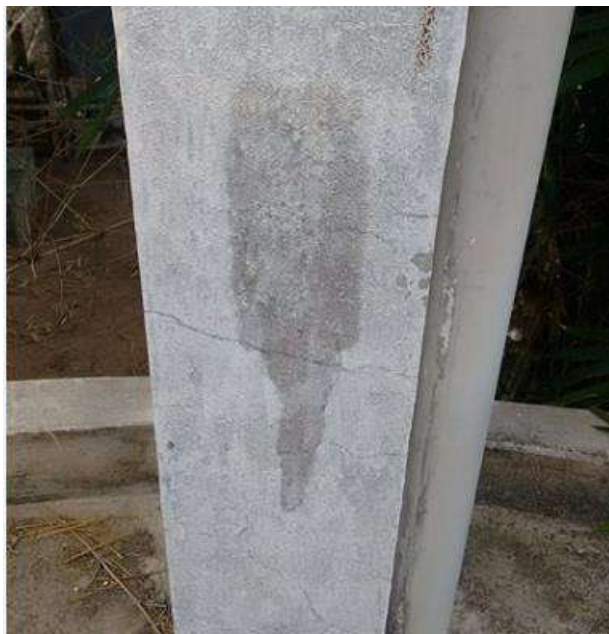
Figura 31 – Aplicação de Fenolftaleína no pilar.
