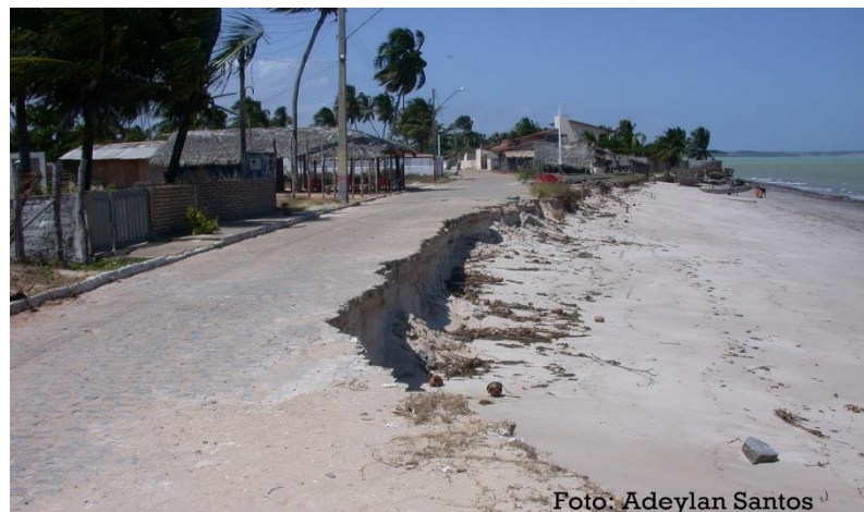
Figura 3 – Destruição de uma rua à beira-mar em Barra de Santo Antônio – PE
