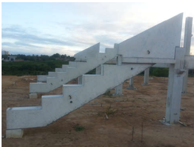
Figura 34 – Detalhe das vigas jacaré
