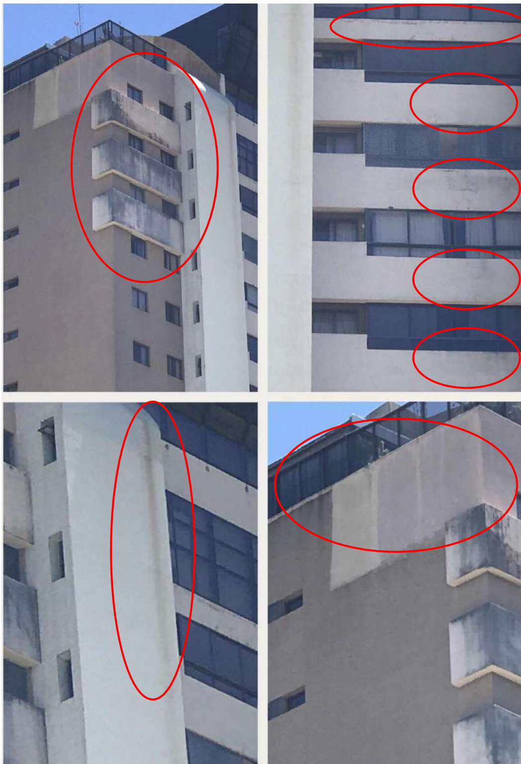
Figura 12: Manchas e mofo na parte frontal e lateral da fachada.
