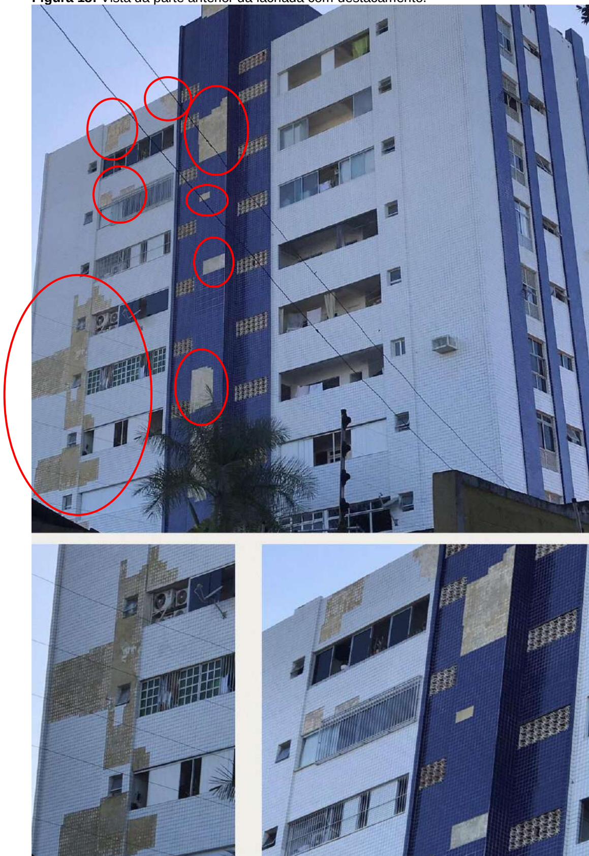
Figura 18: Vista da parte anterior da fachada com destacamento.
