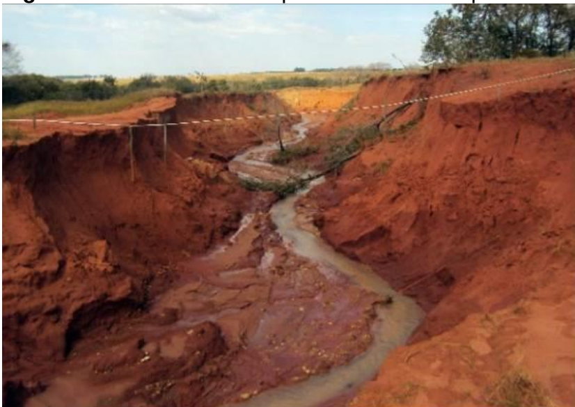
Figura 2 – Erosão causada por escoamento superficial.
