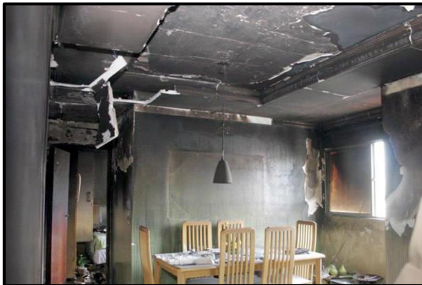
Figura 22 – Vista de caso de incêndio em apartamento em Natal, RN
