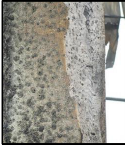
Figura 19 – Estrutura de concreto armado com reação de pop outs
