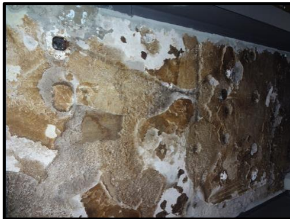
Figura 21 – Estrutura de concreto armado com reação de sloughing
