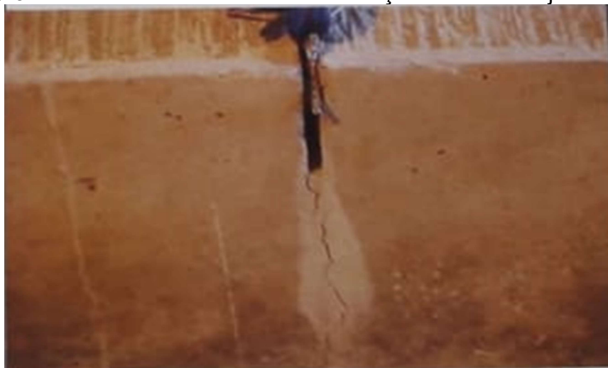
Figura 37 – Detalhe de uma fissura de retração induzida na junta serrada
