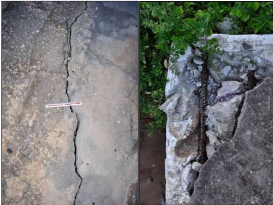
Figura 45 A e 45 B – Detalhe de rachaduras e trincas no bloco de coroamento da fundação, com armadura com corrosão.
