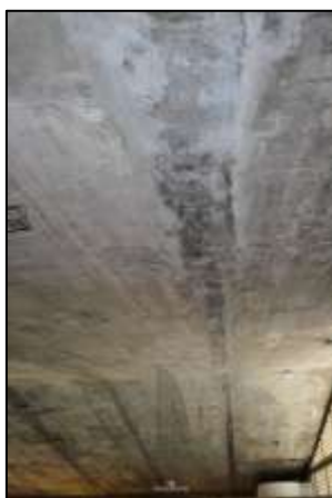
Figura 42 – Viga protendida do Ginásio SESI-SENAI com reparo no cobrimento.
