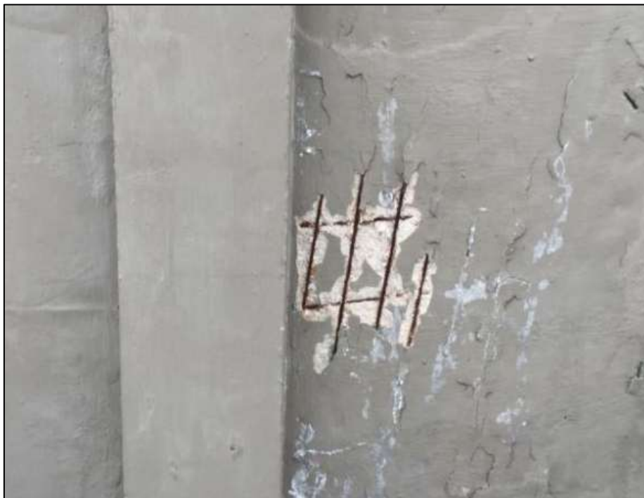
Figura 38 – Corrosão linear na laje de fundo da parte externa, na fachada principal.
