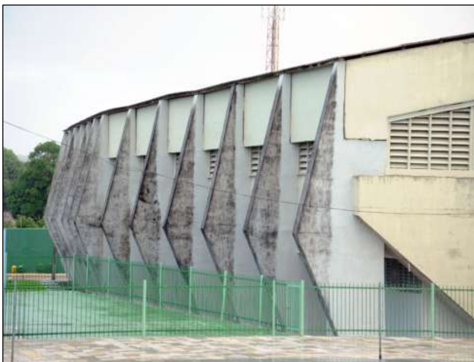
Figura 40 – Pilares dos pórticos com aparência manchada devido agentes agressivos externos.
