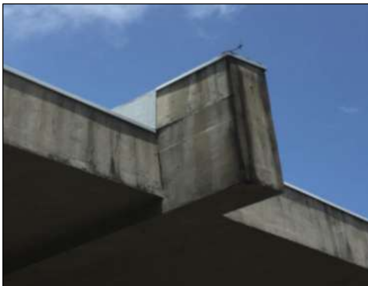
Figura 39 – Ausência de pingadeiras e impermeabilização na viga protendida e na laje.
