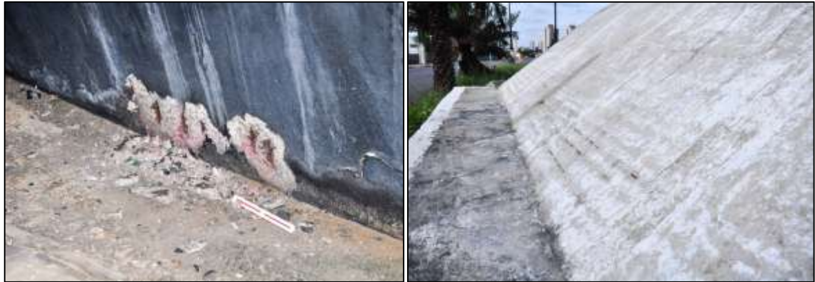
Figura 43A e 43B – Corrosão linear das armaduras passivas da estrutura.
