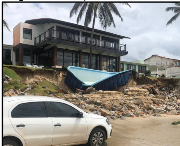
Figura 23 – Colapso da área de lazer.
