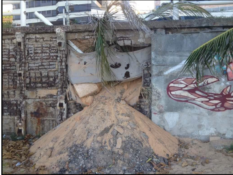
Figura 29 - Deterioração e erosão da cortina de contenção antiga.
