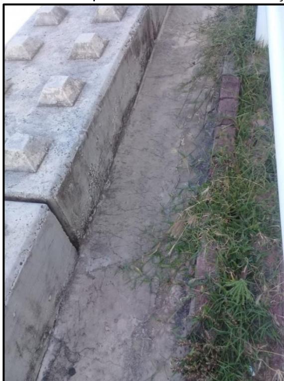
Figura 37 – Fissuras entre o preenchimento e a contenção nova e antiga.
