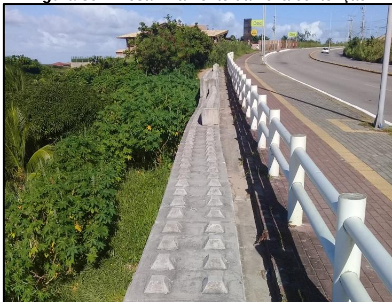
Figura 39 – Desalinhamento da nova contenção.
