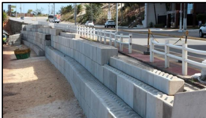
Figura 3 – Contenção do calçadão da praia de Areia Preta.
