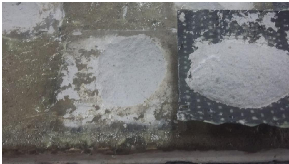
Figura 54 - Aspectos da superfície da lâmina L1 e do substrato da placa de concreto 04 pós-ensaio.
