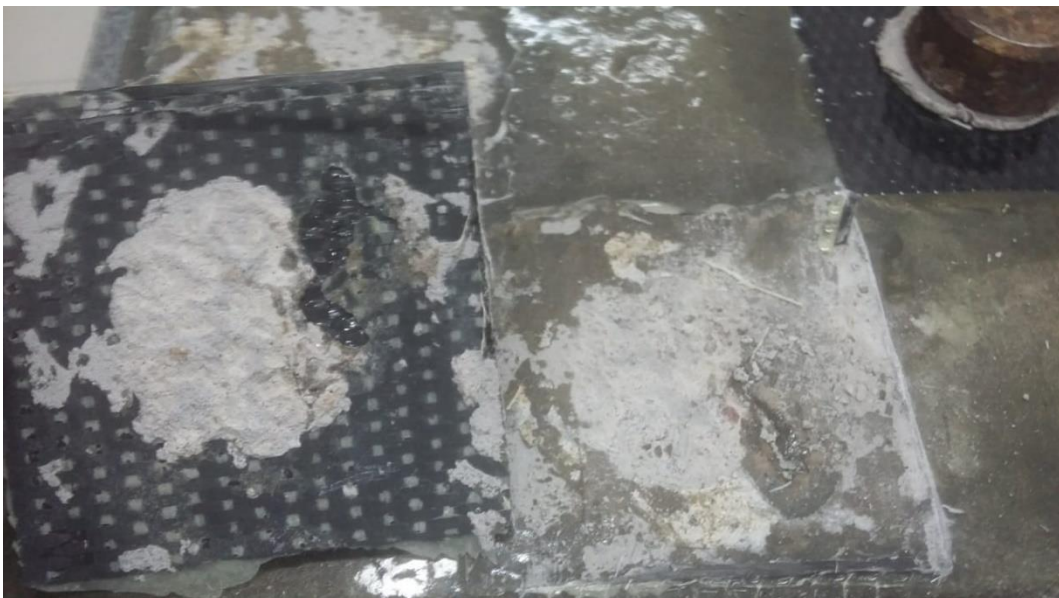
Figura 39 – Aspectos da superfície da lâmina L2 e do substrato da placa de concreto 01 pós ensaio.
