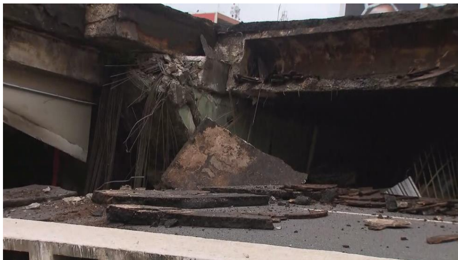
Figura 2 – Detalhe do trecho do viaduto do Eixão Sul que desabou
