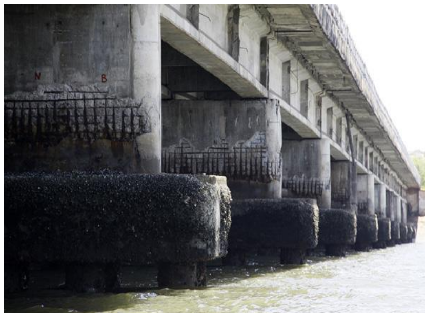
Figura 56 – Detalhe da corrosão dos pilares e deslocamento do concreto – Ponte de Igapó
