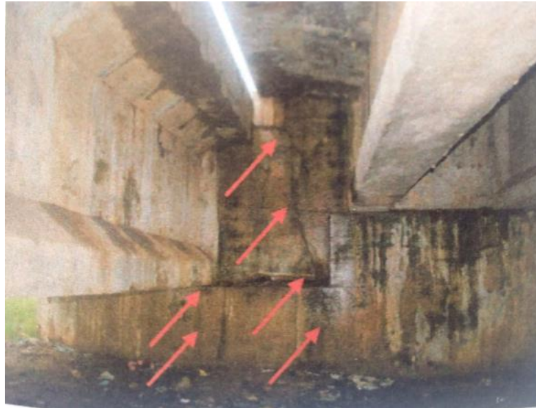
Figura 68 – Detalhe de fissura em um dos encontros
