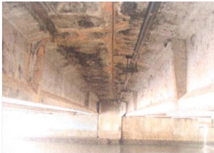
Figura 65 – Vista de junta longitudinal com problemas de vedação
