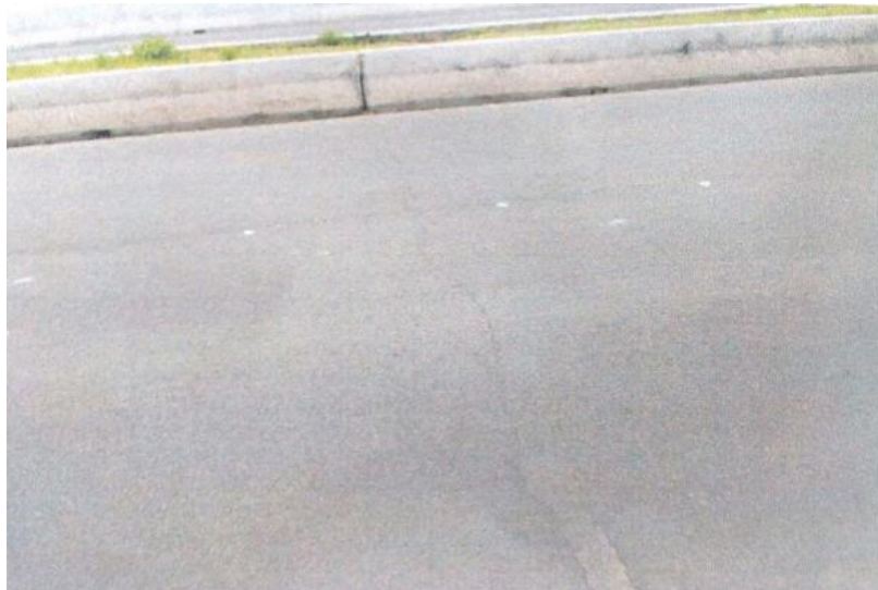
Figura 67 – Detalhe de fissuras no pavimento sobre a junta
