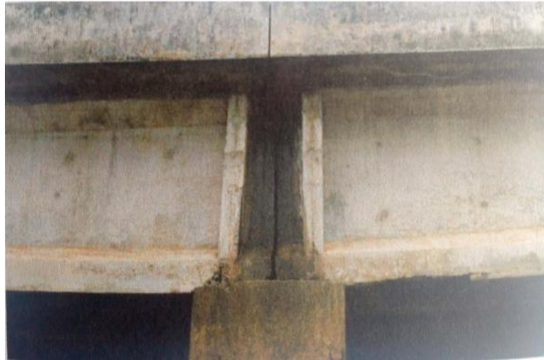
Figura 66 – Detalhe de infiltração causada por deficiência na junta de dilatação
