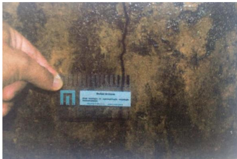
Figura 69 – Detalhe de fissura com 2,5 mm de espessura
