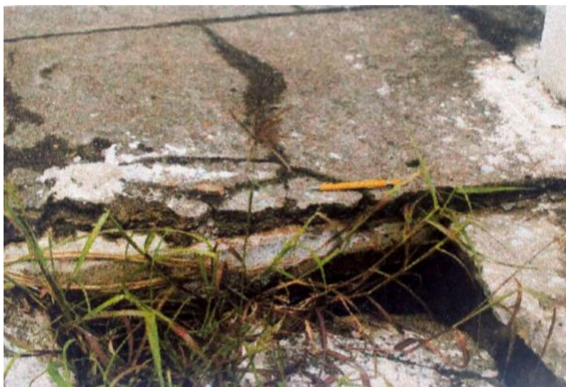
Figura 70 – Detalhe do passeio danificado
