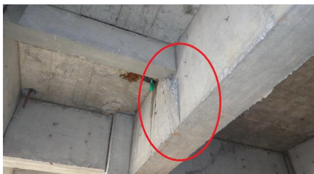
Figura 39 – Detalhe de trinca devido à movimentação das formas
