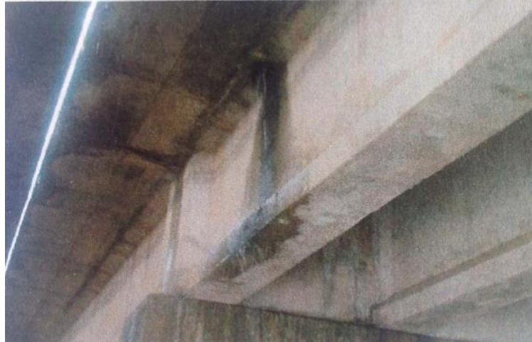
Figura 64 – Vista de dreno mal posicionado sobre talão inferior da viga
