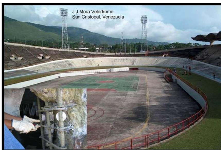
Figura 19 – Detalhe da aplicação de ânodo de sacrifício em pilar do J. J. Velodrome San Cristobal, Venezuela
