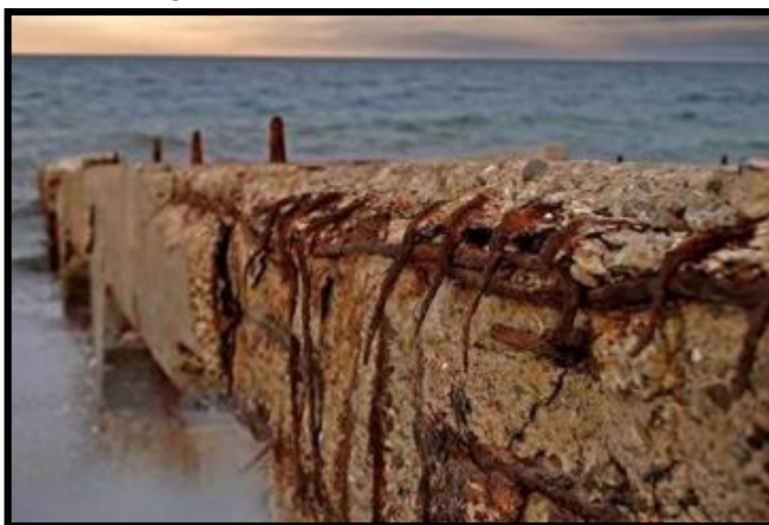
Figura 5 – Corrosão total da armadura.
