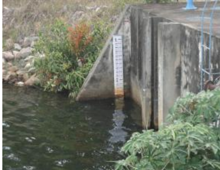
Figura 12 - Tomada da captação de água bruta na Lagoa do Jiqui.
