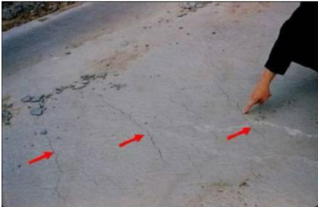
Figura 28 – Fissuração por retração plástica do concreto fresco
