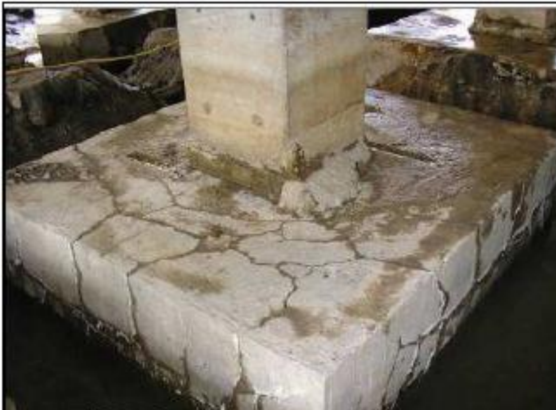
Figura 20 – Reação álcali-agregado em blocos de fundação de edifícios em Recife-PE
