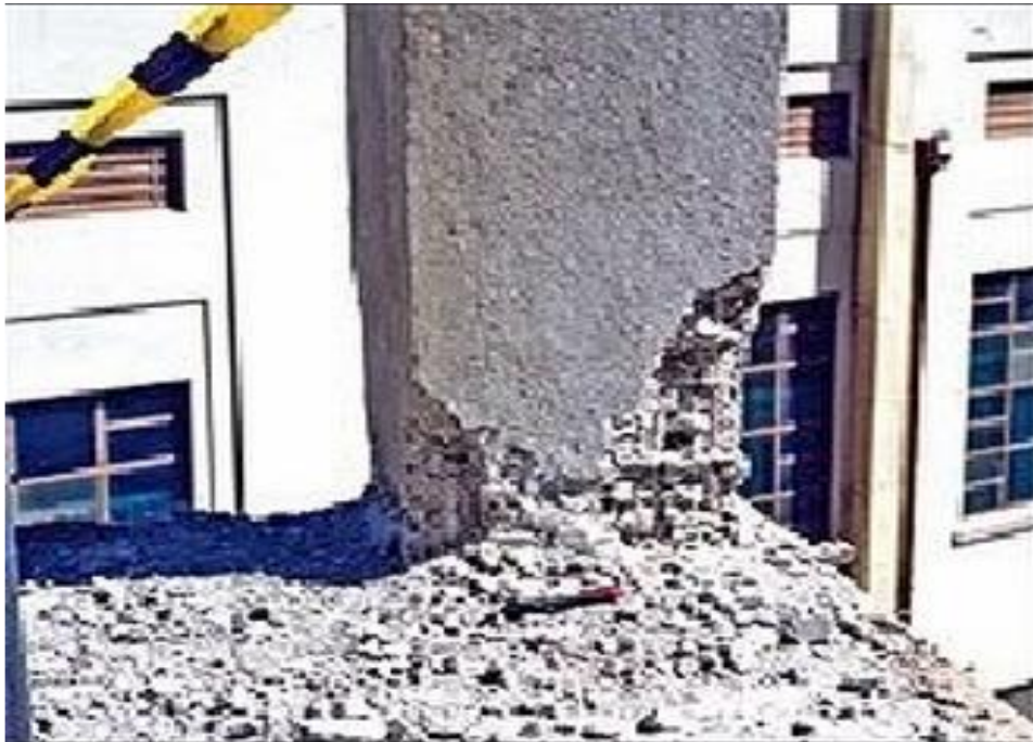
Figura 10 – Falha na execução de pilar
