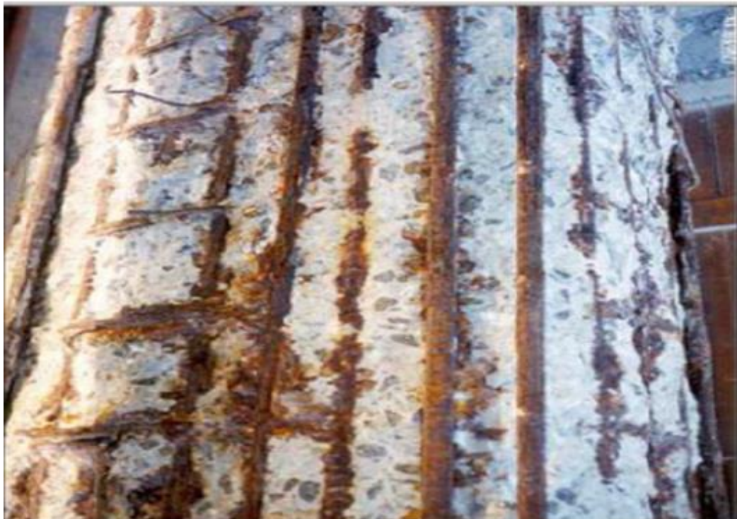
Figura 21 – Deterioração por ataque da água do mar
