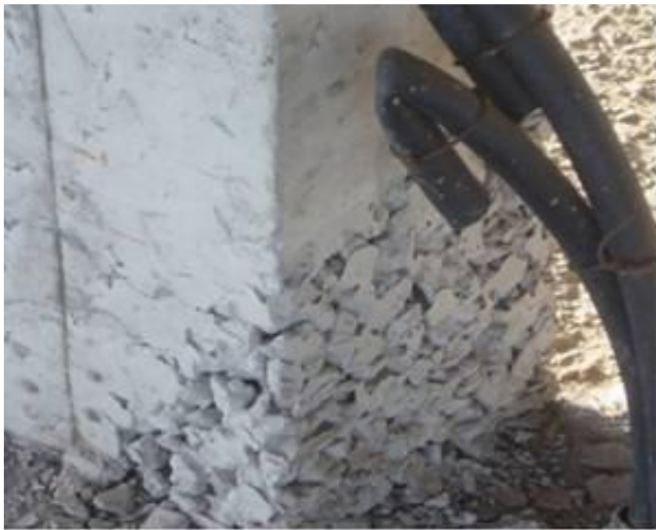
Figura 27 – Ninhos e segregações no concreto
