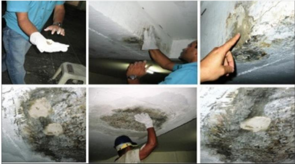
Figura 11 – Variadas manifestações patológicas em estruturas de concreto armado
