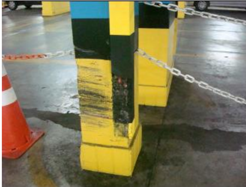
Figura 14 – Proteção de borracha em pilares de garagem
