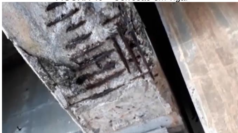
FIGURA 40 – Corrosão em viga.
