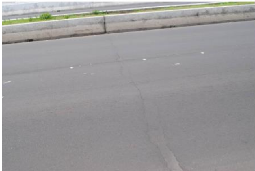
FIGURA 43 – Fissura no pavimento sobre a junta.
