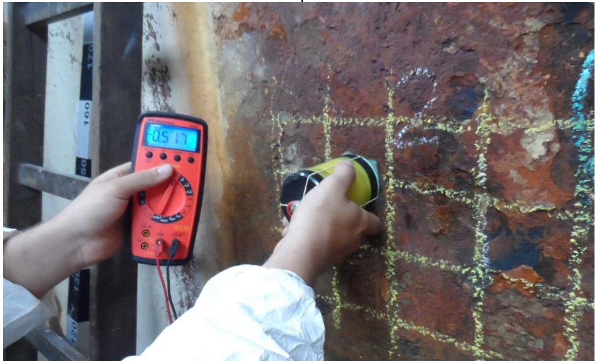
FIGURA 7 – Ensaio de potencial de corrosão.
