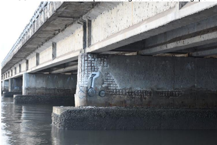
FIGURA 10 – Manifestação Patológica na Ponte de Igapó.
