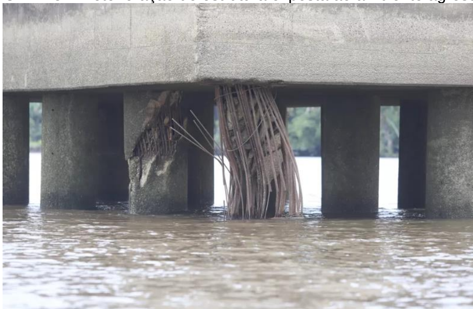
FIGURA 25 – Deterioração de estrutura exposta ao ambiente agressivo.
