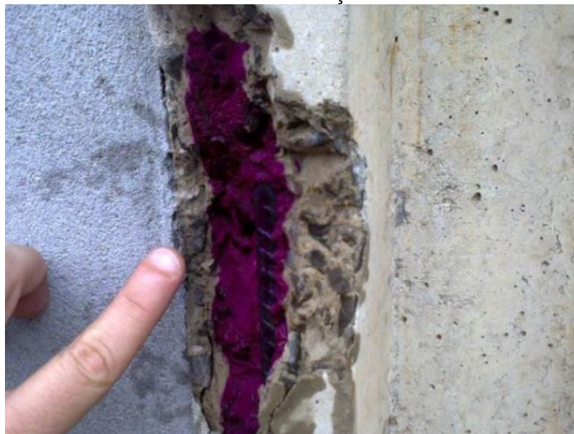
FIGURA 29 – Carbonatação no concreto.
