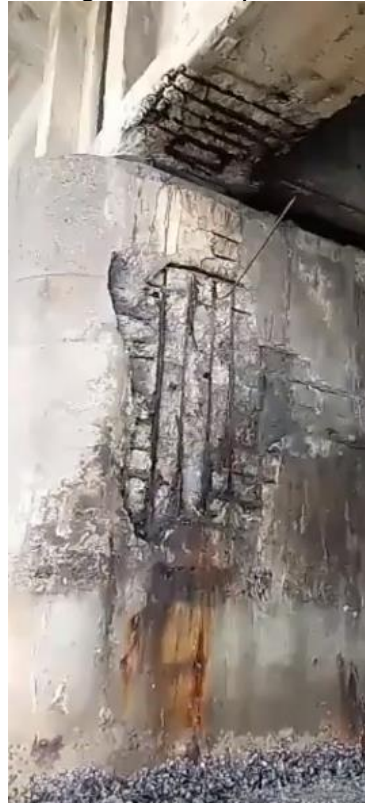
FIGURA 41 – Viga e Pilar apresentam corrosão.
