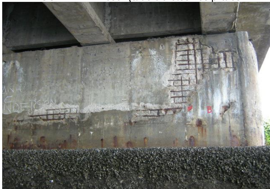
FIGURA 44 – Presença de cloretos nos pilares.
