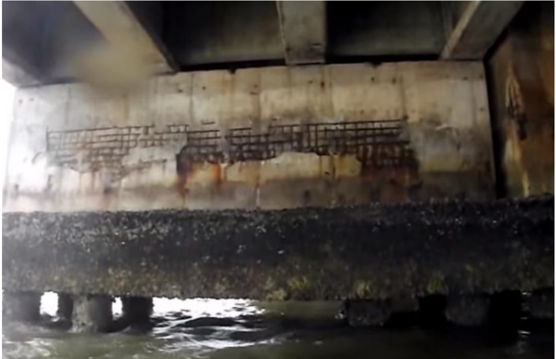
FIGURA 34 – Pilar da ponte apresenta corrosão generalizada.
