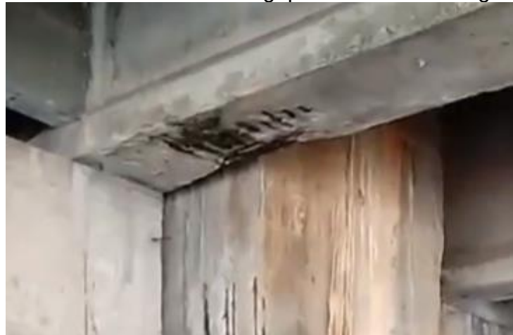
FIGURA 45 – Ponte de igapó: Corrosão em viga.
