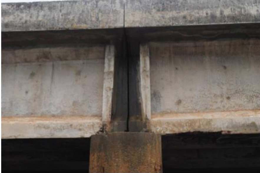
FIGURA 42 – Infiltração causada por deficiência na junta.
