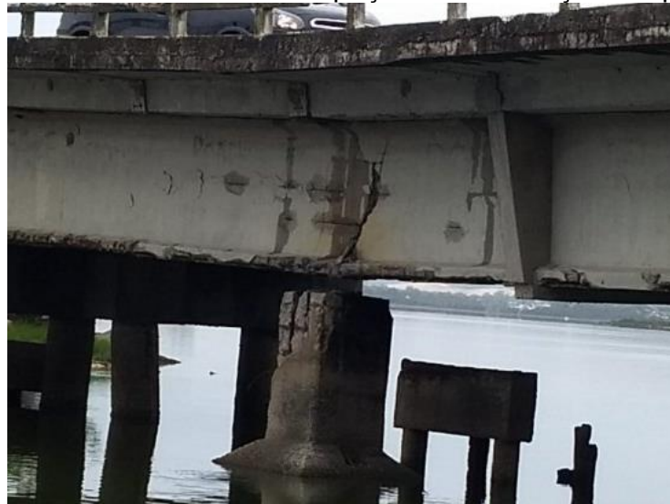
FIGURA 22 – Ausência de Inspeção e Manutenção em ponte.
