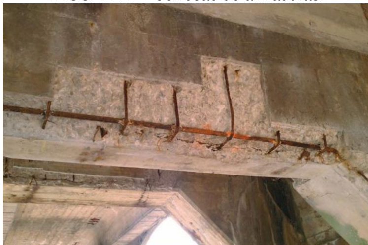
FIGURA 27 – Corrosão de armaduras.
