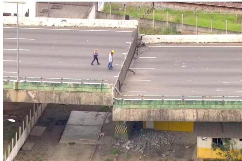
FIGURA 23 – Dano estrutural em viaduto.
