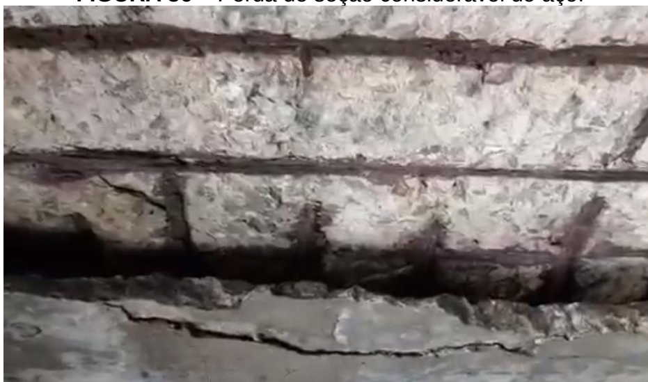
FIGURA 36 – Perda de seção considerável do aço.
