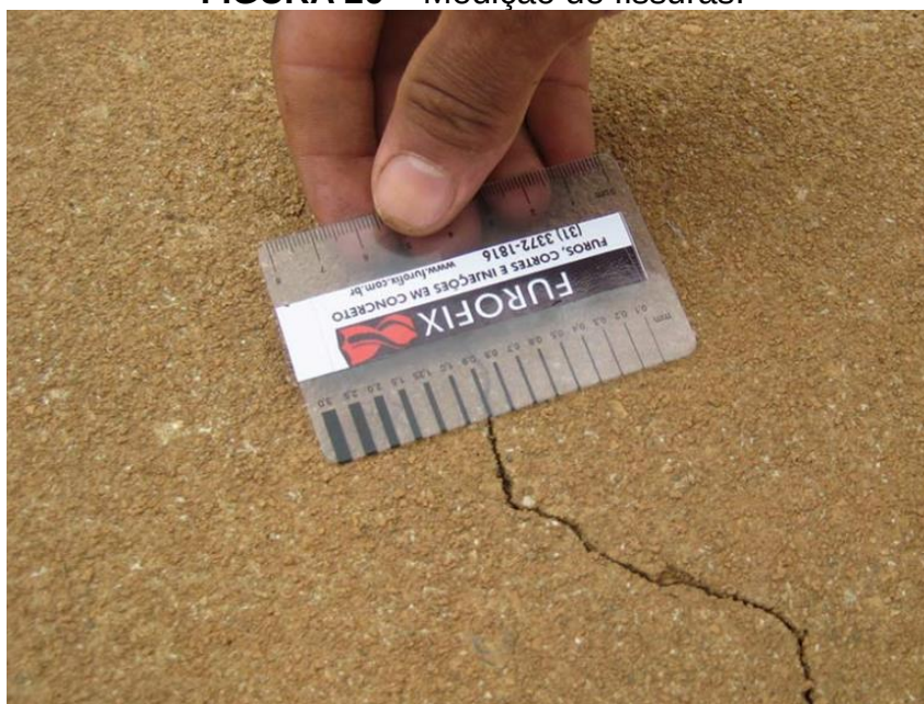
FIGURA 26 – Medição de fissuras.
