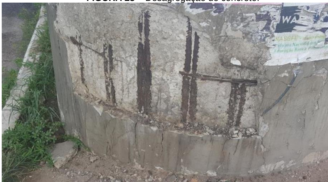
FIGURA 28 – Desagregação do concreto.
