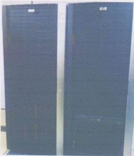
Figura 7 Ao lado esquerdo : HP StorageWorks ao lado direito : HP BLADE SERVER no Data Center da UFRN
