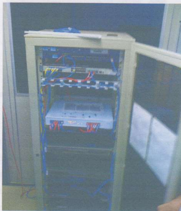
Figura 9 Switchs gerenciáveis no Data Center da UFRN
