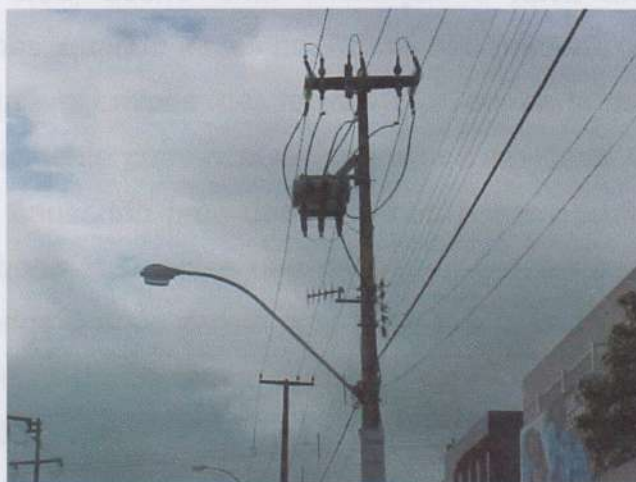
Foto 7 – Chave a Óleo Automatizada na Rede de Distribuição Elétrica Fonte: Foto tirada por Éberth Mastroiani Martins em 29/11/2004
