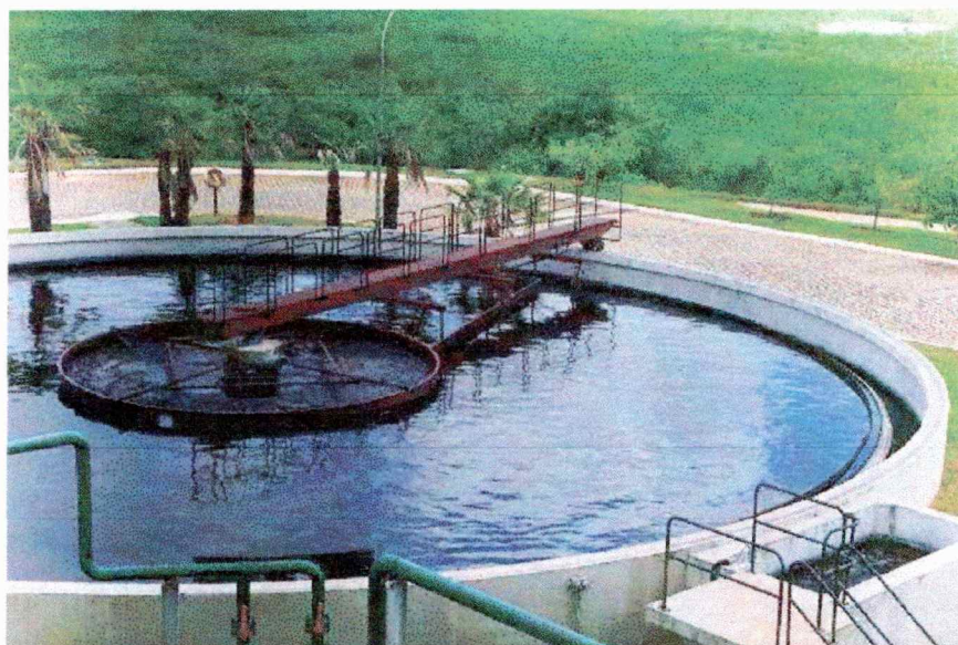
FIGURA 5 – VISTA DO TANQUE DE DECANTAÇÃO DA ETE DA COTEMINAS
