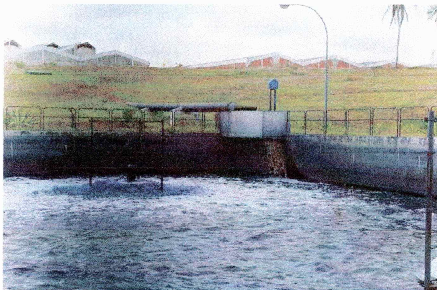
FIGURA 3 - OS EFLUENTES ORIUNDOS DA FÁBRICA ATRAVÉS DE TUBULÕES, CAEM NA CAIXA DE GRADEAMENTO E EM SEGUIDA NO TANQUE DE EQUALIZAÇÃO DA ETE
