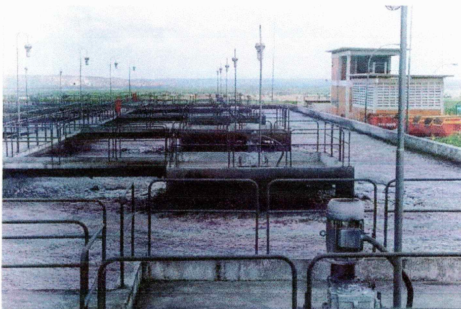
FIGURA 4 - VISTA PANORÂMICA DO TANQUE DE AERAÇÃO DA ETE DA COTEMINAS.
